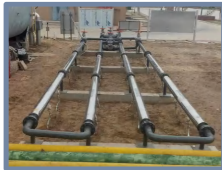
东辛采油厂(500kw)
